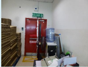
Ảnh 8: Cản trở lối thoát hiểm
